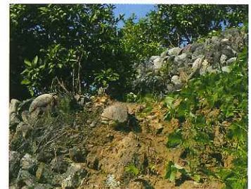
イノシシによる石垣の崩落被害
